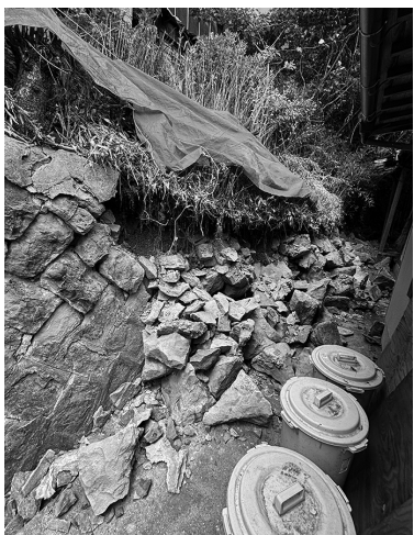
大雨による土砂崩れの被害の様子
